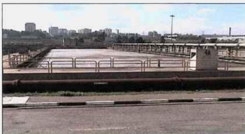
Figura 3.8: - Tanque de aeração da ETE de Barueri.
