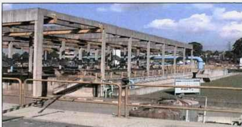
Figura 3.6: - Sistema referente às grades mecanizadas, caixas de areia e tanques de pré-aeração, pertencente a ETE de Barueri.
