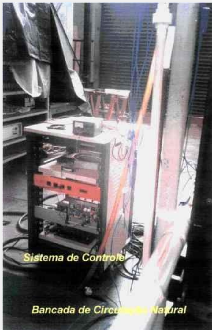
Figura 10 – Sistema de Controle da Bancada de Circulação Natural
