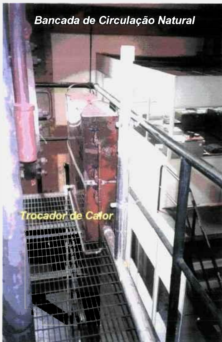
Figura 9 – Trocador de Calor da Bancada de Circulação Natural
