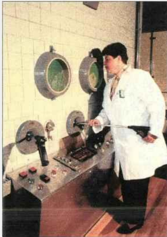
Figura 11 - "Hot cell" para manipulação do fio radioativo - painel frontal
