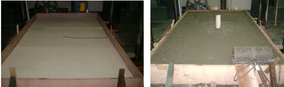
Fotografia 1. (a). Aspecto do molde da placa já com a placa de poliuretano colocado e um termômetro no centro da placa para leitura da temperatura no subleito (TE14 ou TFUN). (b) Colocação da base sobre o subleito. No centro foi colocado um tubo de 120,0 mm de diâmetro para moldar o poço onde foi colocado a célula de carga.
