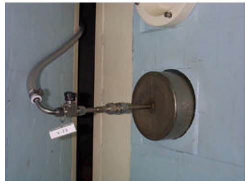
Figura 4. Válvula de entrada dos rejeitos salvaguardados na Célula Quente
