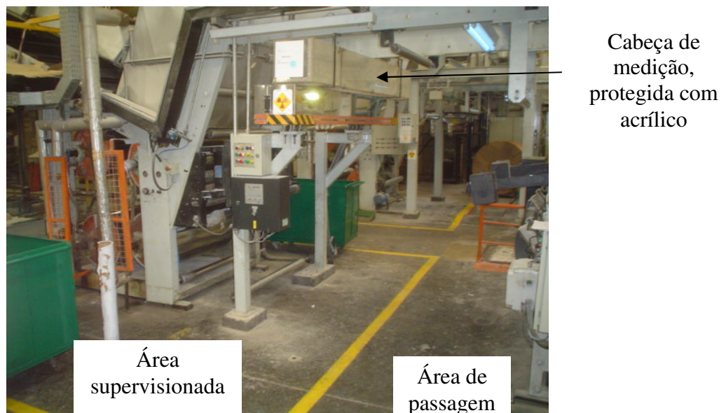
Figura 2. Local de instalação indicando a sinalização de área supervisionada, a blindagem de acrílico para proteção da passagem e a cabeça de medição.
