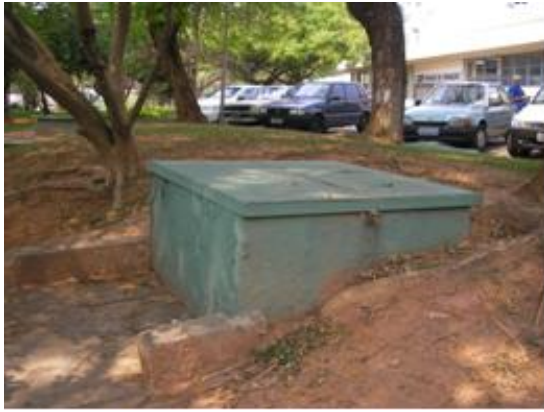
Effluent retention tank TR1
