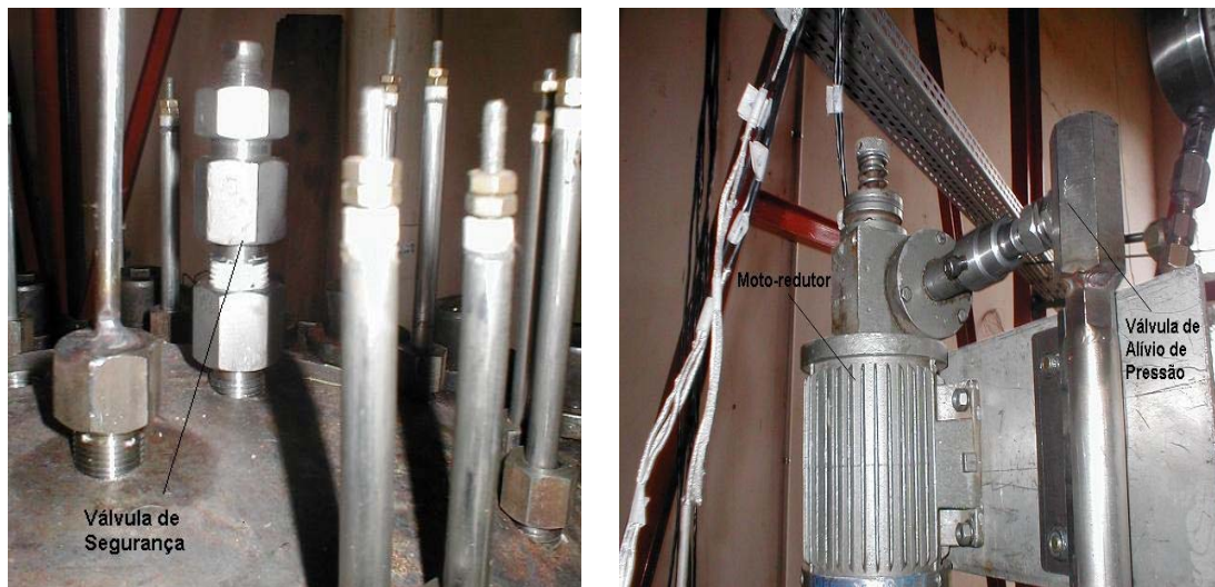
Figura 13 – Válvulas de segurança e de alívio de pressão.
