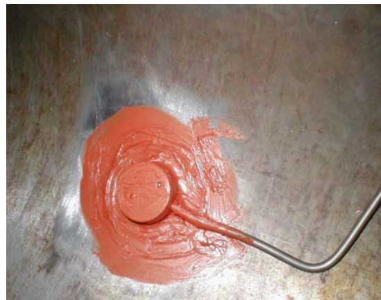
Instalação protegida por borracha de silicone
