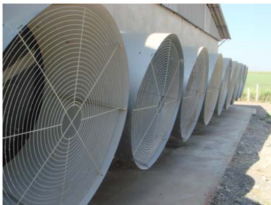
Figura 2 – Ventiladores tipo “túnel” instalados em granjas avícolas Figure 2 – Tunnel ventilations installed in poultry farms
