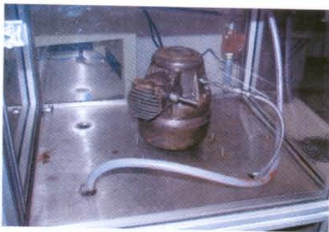
Figura 7: Compresor en cámara de ensayo de presión hidrostática
